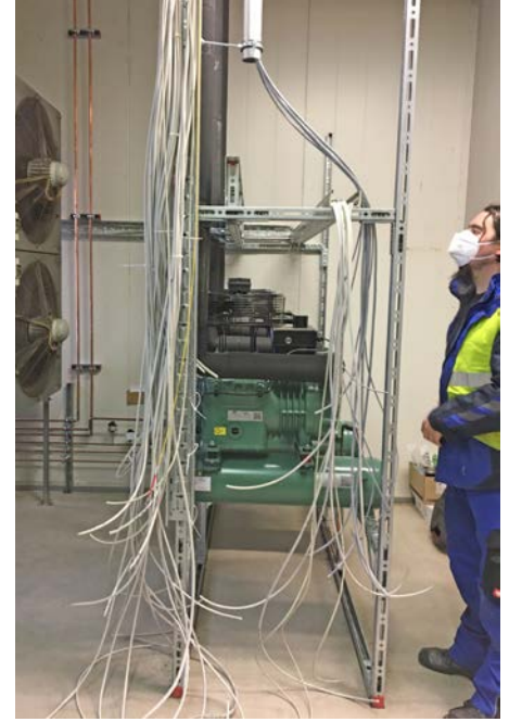
Noch gibt es „Kabelsalat“, den Peter Volland bald beheben wird.
